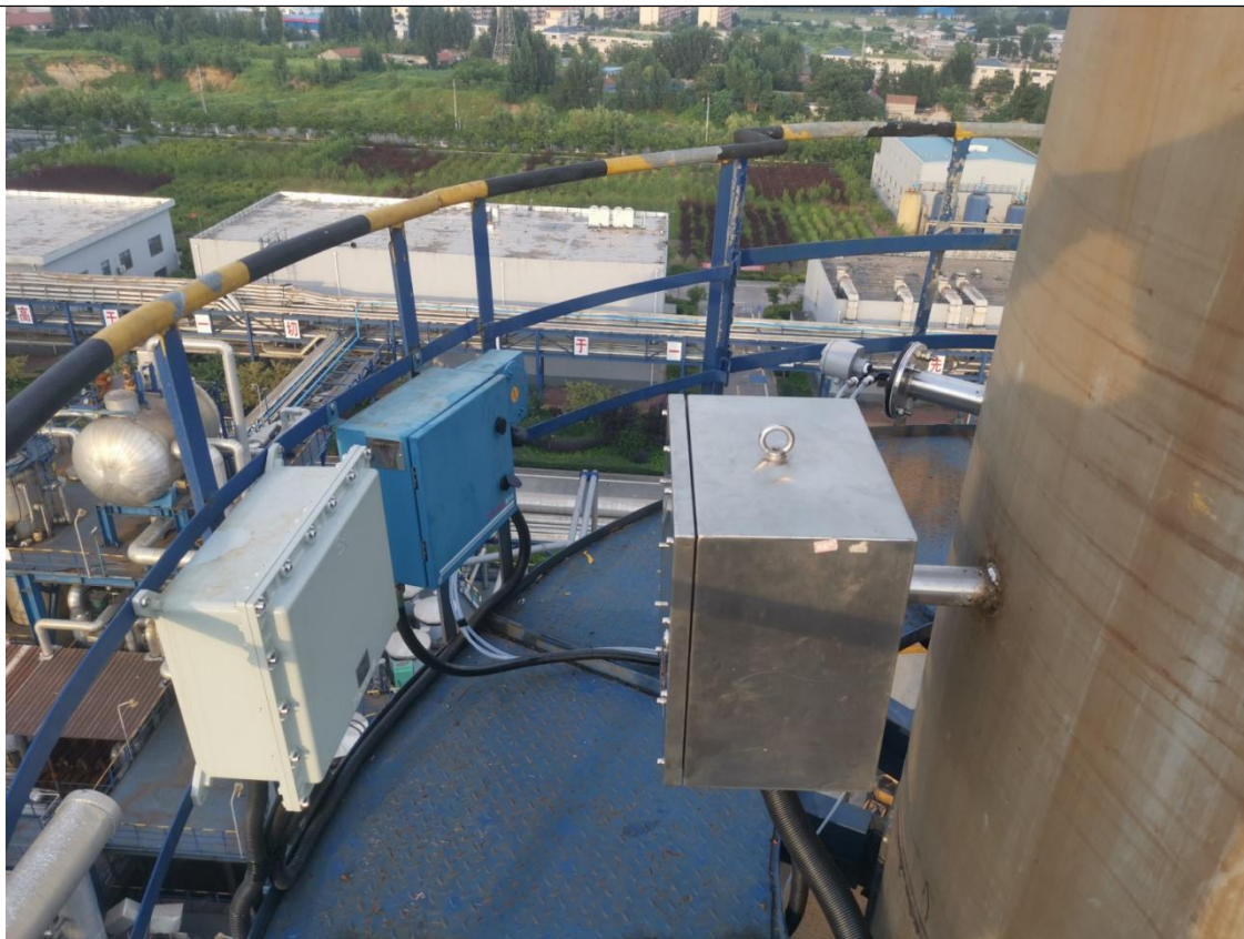
采样口及采样平台
