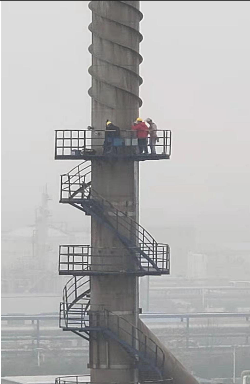
排气筒及采样平台
